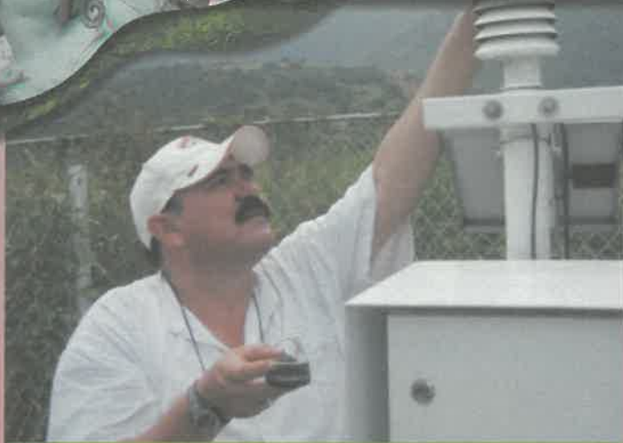
Figura 1. Instalación de Unidades Meteorológicas Automáticas.
